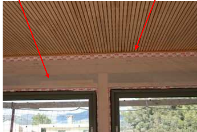
Infiltrations d'air dans l'isolant au dessus de la fenêtre située au dessus de la future trémie d'escaliers. Vue des « crayons » matérialisant les infiltrations d'air dans le Lignotrend en rive de plancher haut.
