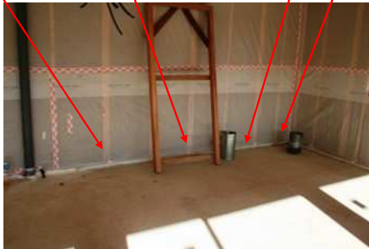
Infiltrations d'air mise en évidence uniquement en dépression dans l'isolation basse du mur Nord Est.
