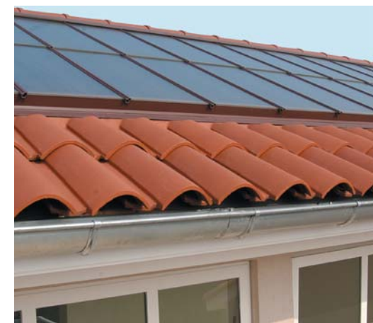
Les panneaux solaires de l'Hélios (Lyon 8 e )
