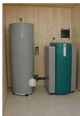
Pompe à chaleur reliée à un ballon d'eau
