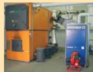
CHAUDIÈRE BOIS ET CHAUDIÈRE FIOUL
