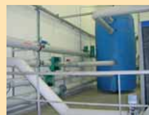
BALLON D'EAU CHAUDE
