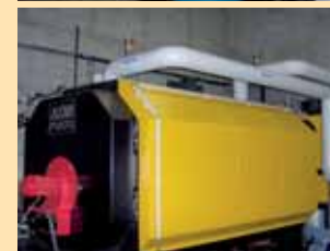
LA CHAUFFERIE (INTÉRIEUR)
